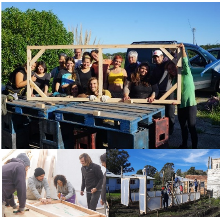
Figura 18. Capacitación acción construcción invernaderos modulares zona playas del sur Mar del Plata. Abril, mayo, junio 2022
